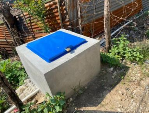
Caja y válvula de control
