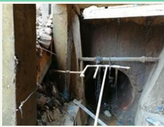
Tubería PVC expuesta
